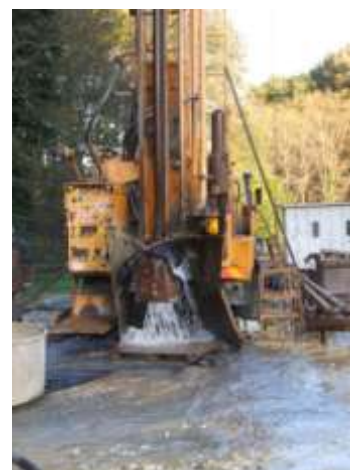
Captage de St Césaire "Chez Veillon F 2 " : Foration du réservoir captif du Cénomaniens
