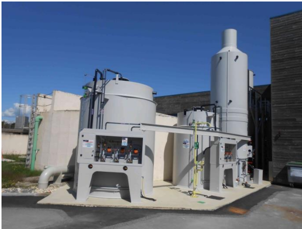
Les tours de traitement
