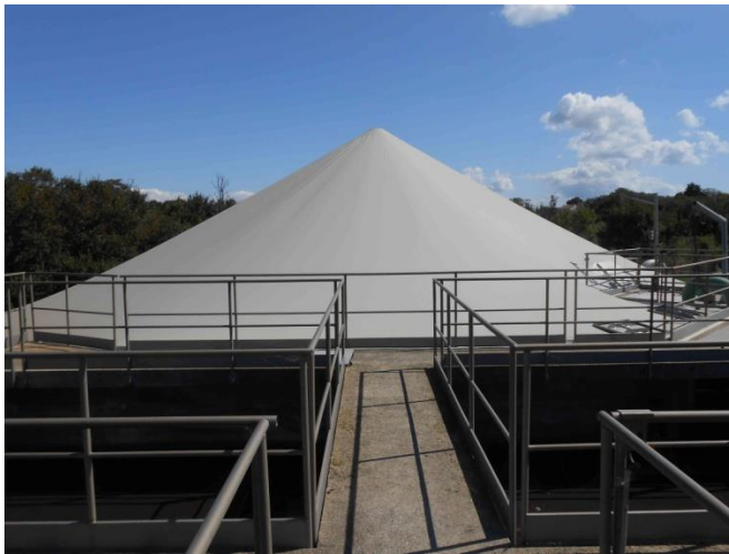
La couverture du bassin tampon
