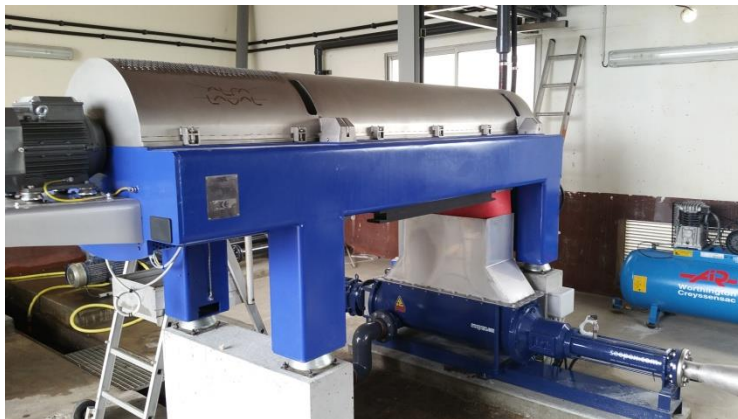
Centrifugeuse installée dans le local existant
