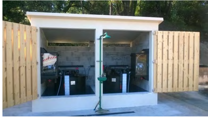
Local de stockage des réactifs
