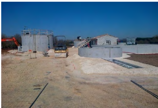
Station d'épuration de Bussac sur Charente
