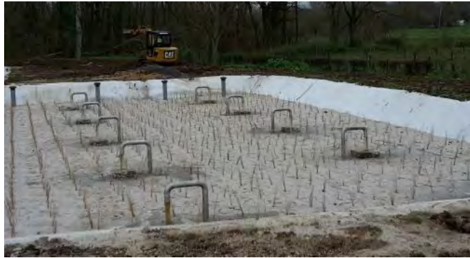
Filtres plantés de roseaux
