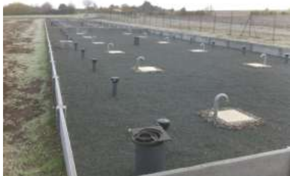
Station d'épuration de Cram-Chaban
