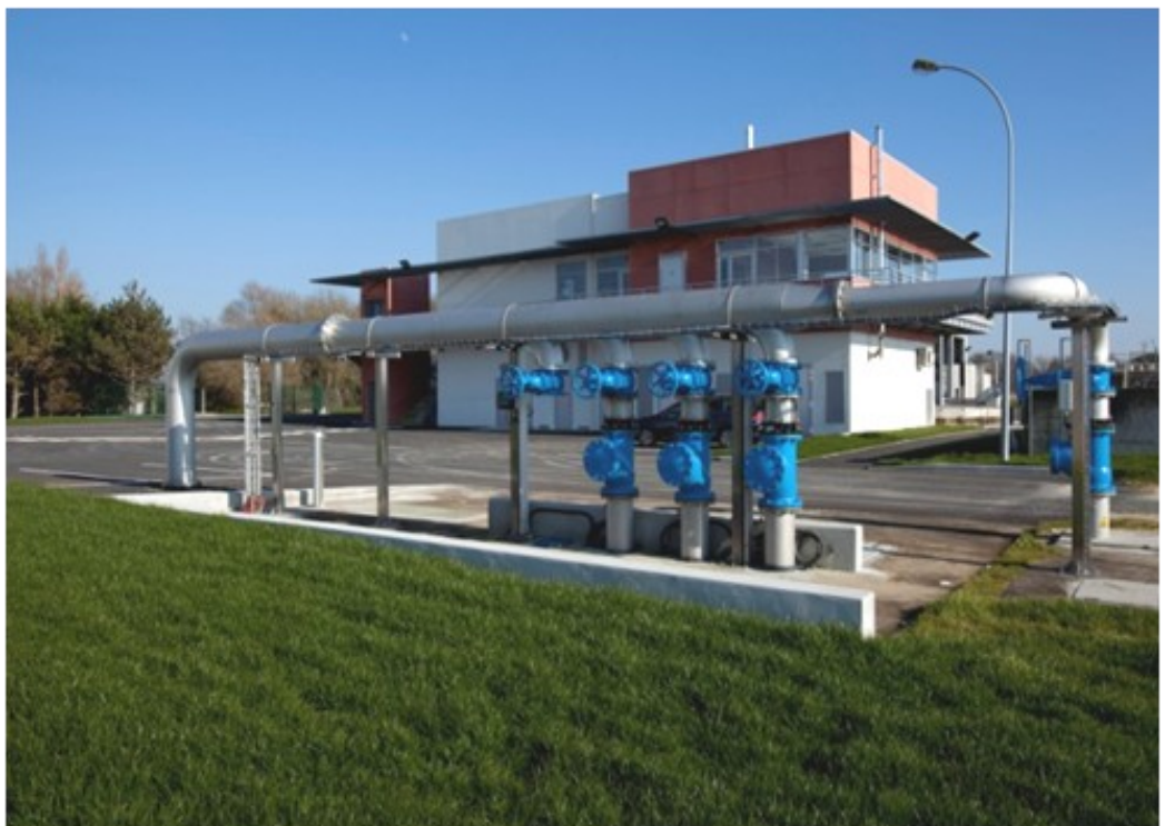
Station d'épuration de La Côtinière
