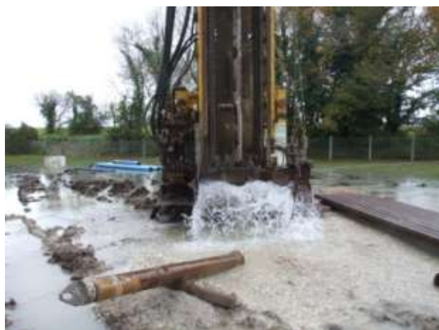
Captage de Poursay Garnaud "Bois de Vervant F 2 " : Soufflage du réservoir après tubage.
