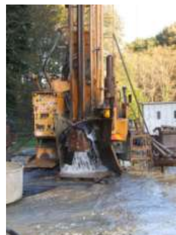
Captage de St Césaire "Chez Veillon F 2 " : Foration du réservoir captif du Cénomaniens
