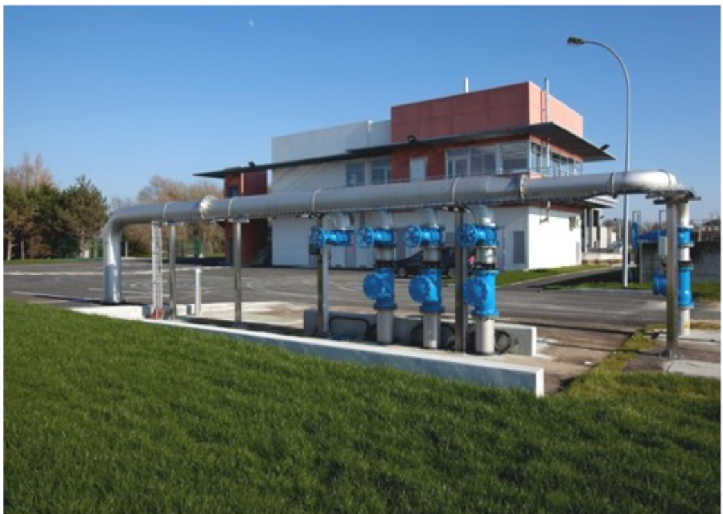
Station d'épuration de La Côtinière
