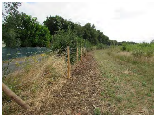
Acquisition de terrains à proximité du captage de St Laurent de la Prée et pose d'une clôture de protection.
