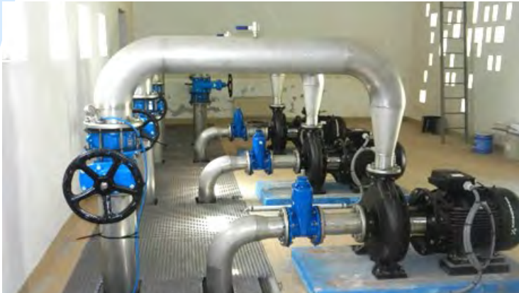
← Station de pompage du Bois Henri IV à LA COUARDE SUR MER
