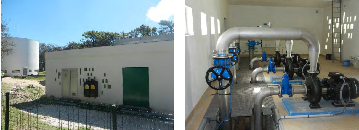
Station de pompage du Bois Henri IV à La Couarde sur Mer
