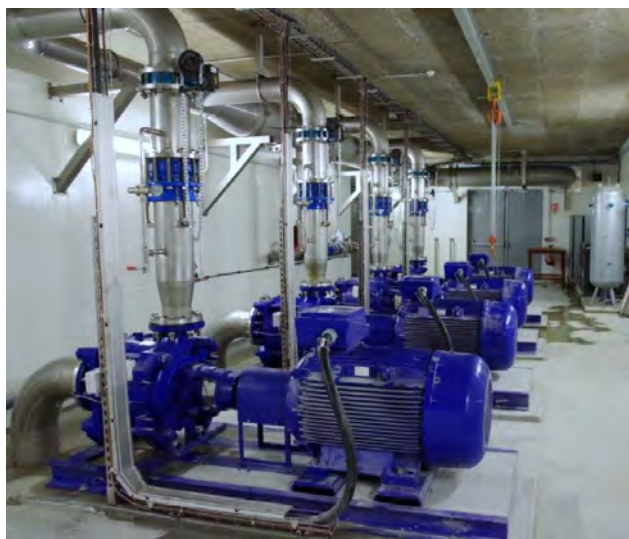
Pompes de reprise vers le réservoir de Belmont
